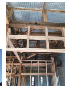
屋根・外壁にセルロースファイバーを現場吹付。サッシは全て取替。
