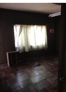
④洋室床板がはがれてきている。
