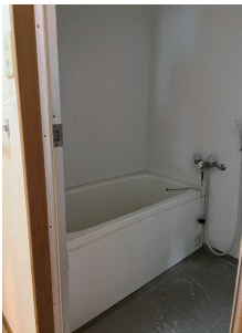
混合水栓が入居者ニーズに合わない
