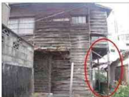
柱の数箇所に破損がある例
