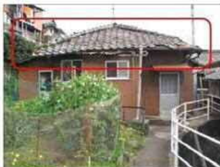
屋根に不陸がある例
