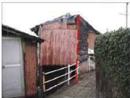
一部の柱が傾斜している例
