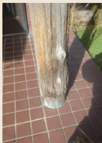
傷んだポーチ柱
