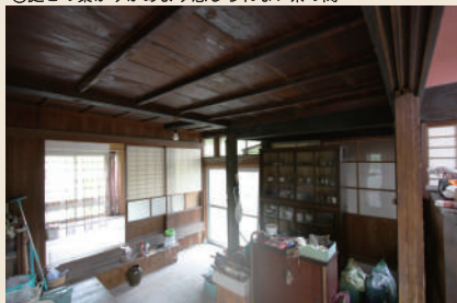
②出入口ともとの欄間に矛盾が生じている
