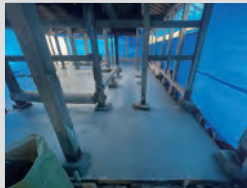
傷んだ構造材や束石の補強・取替をし、床下にコンクリートを打設している。
