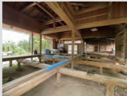
解体がほとんど終わる段階。囲炉裏の煙で燻された立派な構造材が姿を現した。
