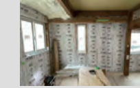
単板サッシから Low-E 複層ガラスの複合サッシに代わり断熱性が向上した。
