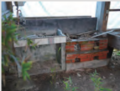
かまどで調理する形のかつての炊事場。壁が崩れ雨ざらして傷みが大きかった。
