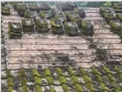
白蟻除去の様子。既存の瓦は割れたり欠けたり苔が生えたり、傷みが大きかった。
